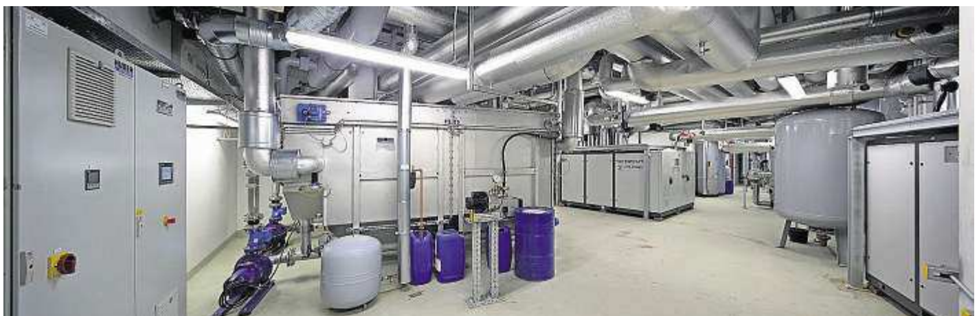
→ In der Mitte ist der Wärmetauscher zu sehen, durch den das Abwasser aus dem Kanal fließt. Die Wärme, die hier entzogen wird, bringt die Maschine im Hintergrund zur Beheizung auf ein höheres Temperaturniveau. Im Sommer wird das System auch zur Kühlung verwendet.
