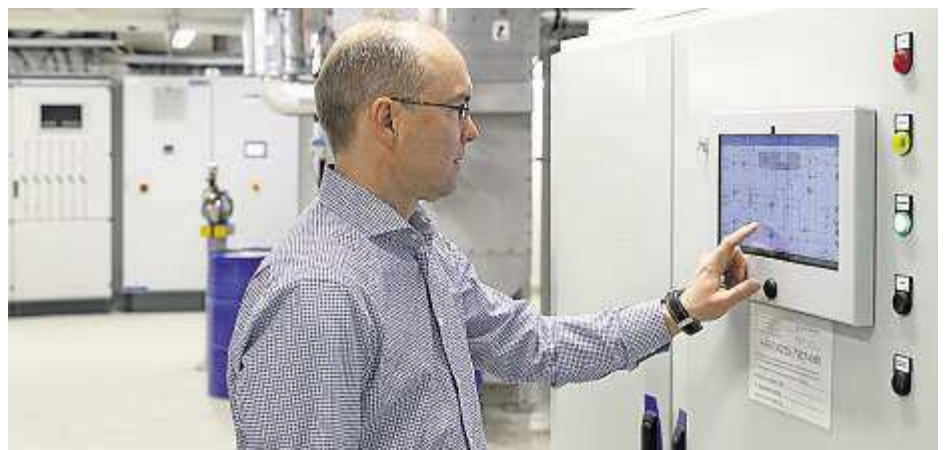
→ Wärmepumpe und Kältemaschine in einem: Projektleiter Udo Ziegenthaler prüft die Anlage, die Wärme und Kälte gleichzeitig erzeugen kann
