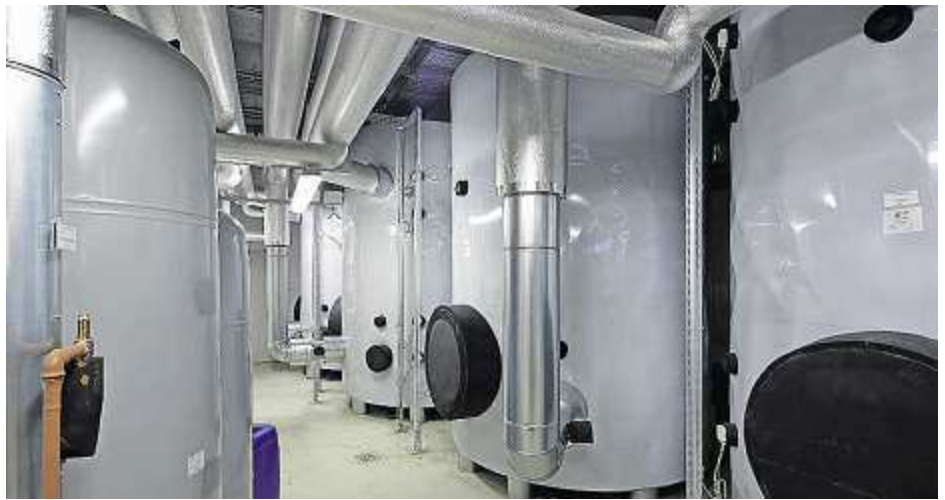
→ In diesen vier Behältern wird Kälte gespeichert
