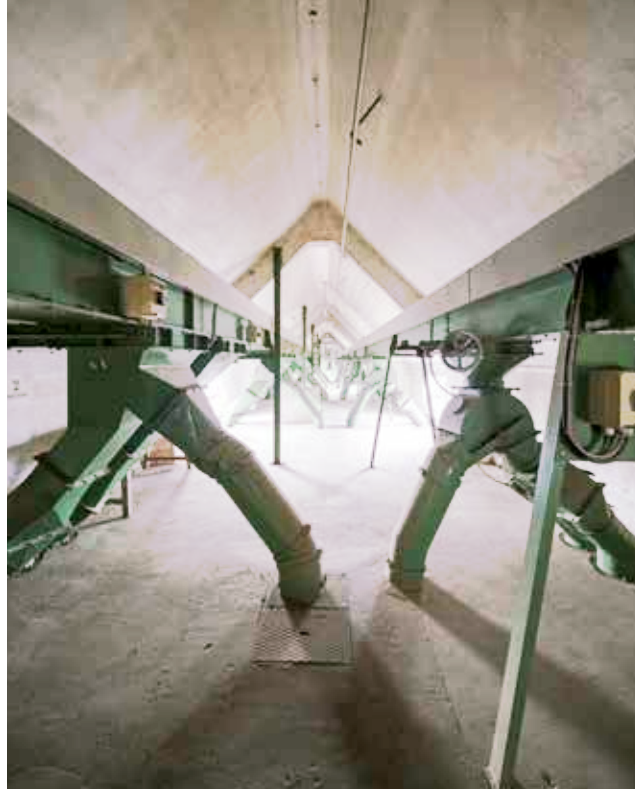
Förderbänder im Dachgeschoss Mitteltrakt
