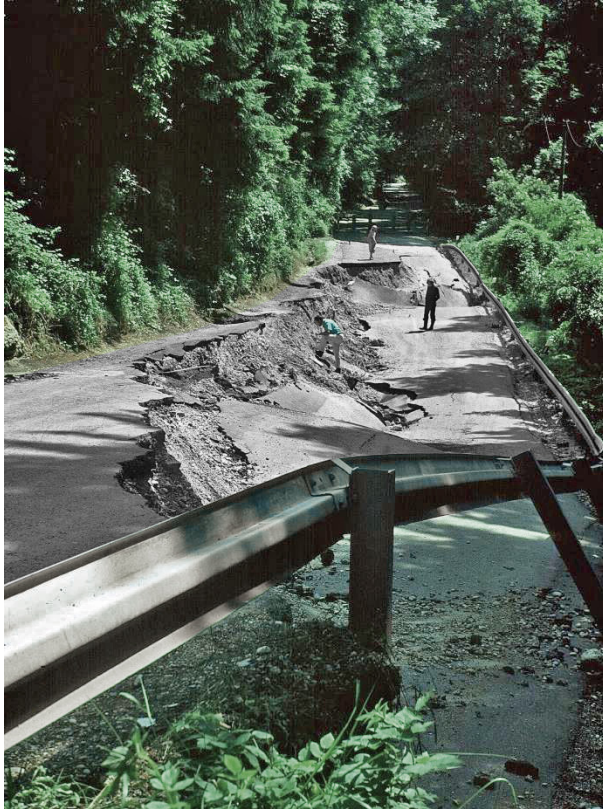
Abb. 5: Tiefreichende Rutschungen verursachen wiederkehrende Straßenschäden.
