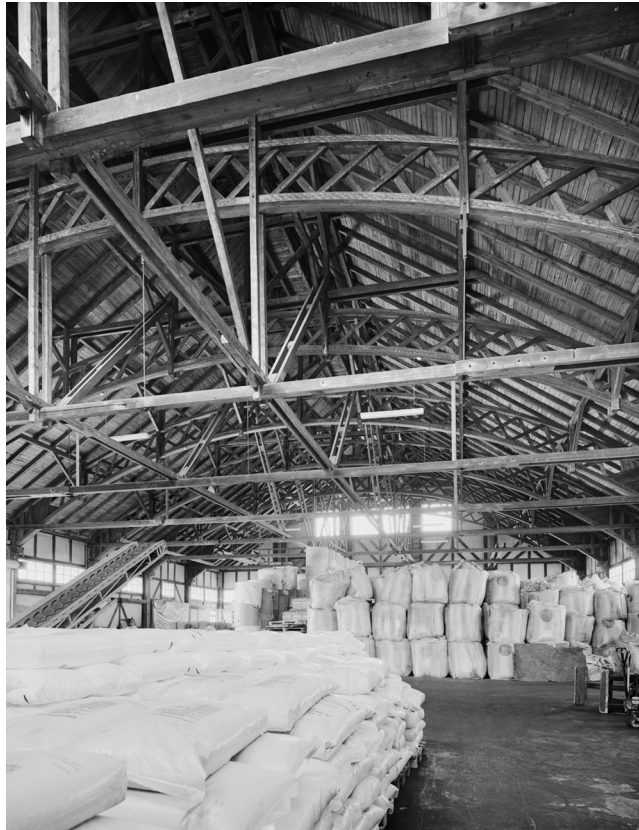
Abb. 44, 45: Die Süddeutsche Halle in der Wiener Straße 13 – offen- sichtlich Wolfgang Wallers Arbeitsplatz – im Jahr 1994, kurz vor dem Abriss. Foto: Stadt Regensburg, Peter Ferstl.
