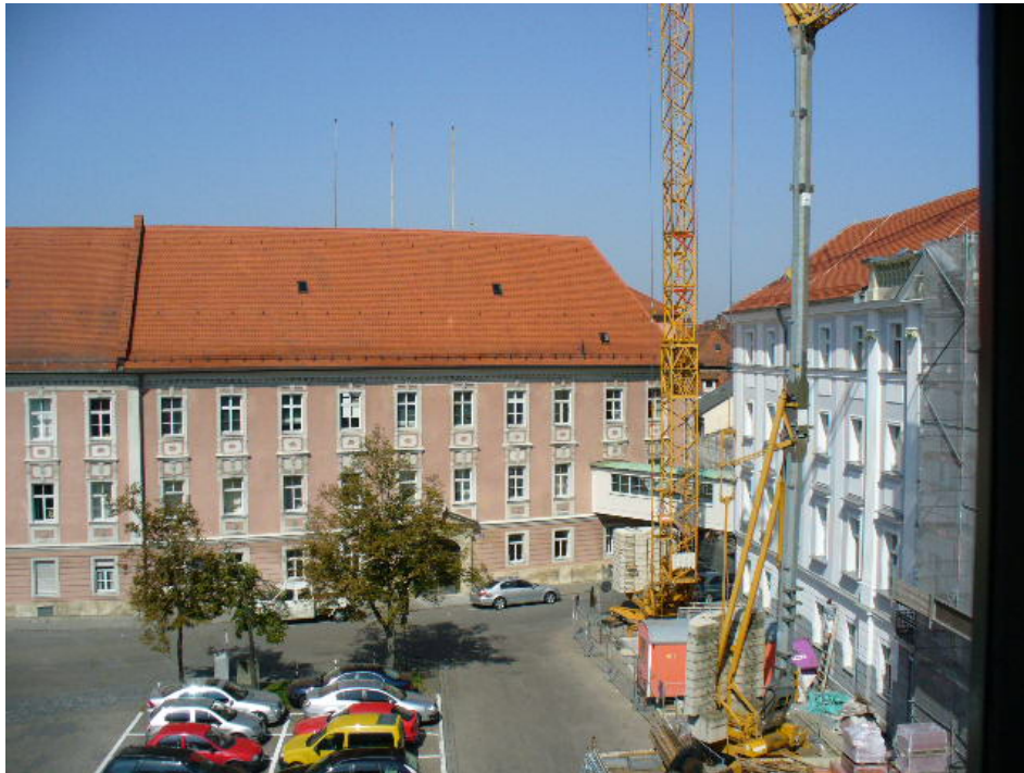
Bild 1: Blick von Messpunkt 1 zum Antennenstandort (Antennen unter der "Dachhaut")
