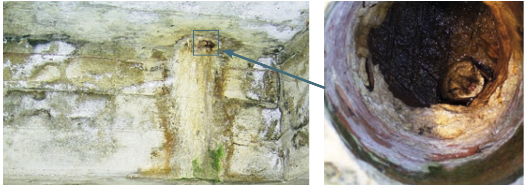
Abb. 32, 33: Fledermausquartier in einem Abflussloch unter einer Betonbrücke. Der Blick hinein verrät: Hier lebt eine Fransen- fledermaus.
