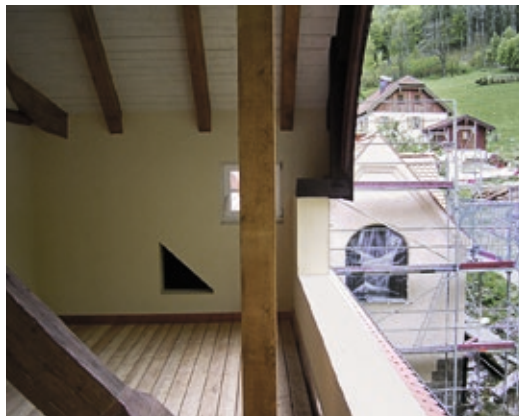
Abb. 57 (links): An dieser Dachterrasse wurde eine zusätzliche (dreieckige) Öffnung zu dem dahinterliegenden Dachboden geschaffen.
