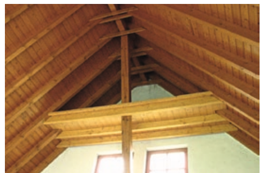
Abb. 34: Kotbrett unter dem Quartier (Pfeile) einer Kolonie Breitflügelfledermäuse in einem Kindergarten. Normalerweise sind Kotbretter jedoch weniger auf- wändig und schmaler gearbeitet.
