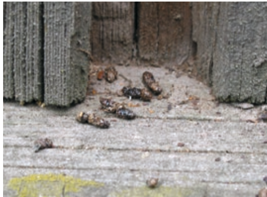
Abb. 8 (rechts): Kotspuren am Fuß der Fassade eines Hochhauses (Abendseglerquartier hinter Dachverblendung).
