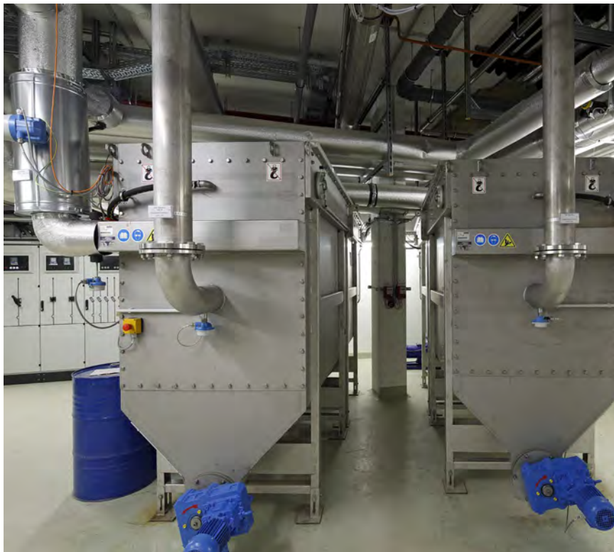
Blick in die Technikzentrales des Museums.
