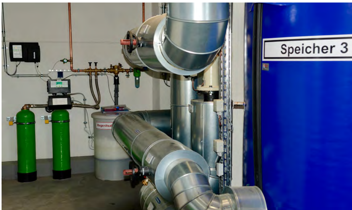
Blockheizkraftwerke (BHKW) einschließlich Pufferspeicher bilden das Herzstück der Energie-Effizienz-Quartiere.
