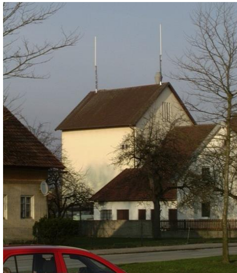
Abb. 1: Beispiel für eine Mobilfunksendeanlage mit omnidirektionalen Antennen.
