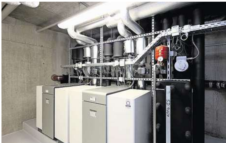
→ Eine Wärmepumpe gehört zu den umweltfreundlichsten Heizsystemen
