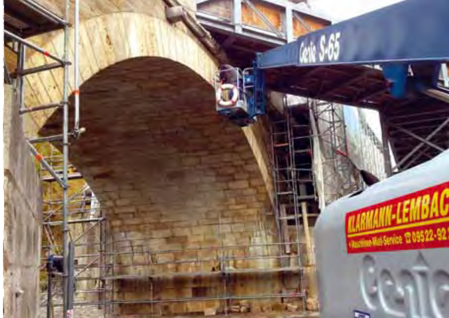
▲ Von links: saniertes Stirnbogen mit Verpressröhrchen, saniertes Bogen XV mit vorbereiteten Vierungen zum Einsetzen, Instandsetzung Blendmauerwerk Bogen XI
