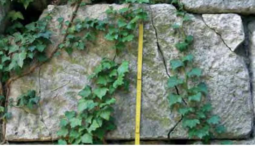
▲ Einer von zahlreichen Schäden durch Rissbildung in einem Steinquader der Südost-Ecke des römischen Legionslagers
