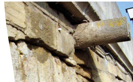
Verschiebungen im Mauerwerk
