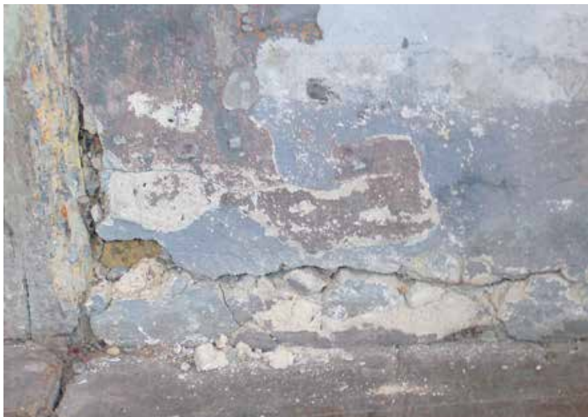
▲ Opfer unkontrollierter touristischer Nutzung: die einstige Türmerwohnung im Brückturm (um 1650). Das Bild, aufgenommen im März 2011, zeigt vorwiegend durch Bestoßung verursachte Schäden im Sockelbereich.
