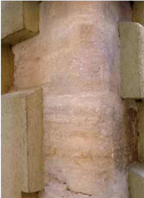
◀ Wärmedämmung als ästhetischen Problem: Historische, für die Eigenart eines Gebäudes charakteristische Fassadendetails verschwinden oder werden, wie die Steinquader dieses Hausecks, aus dem Dämmpaket ausgeschnitten. Die Folge sind scharfkantige, gleichsam unnatürliche Versprünge zwischen der alten und der neuen Oberfläche.
