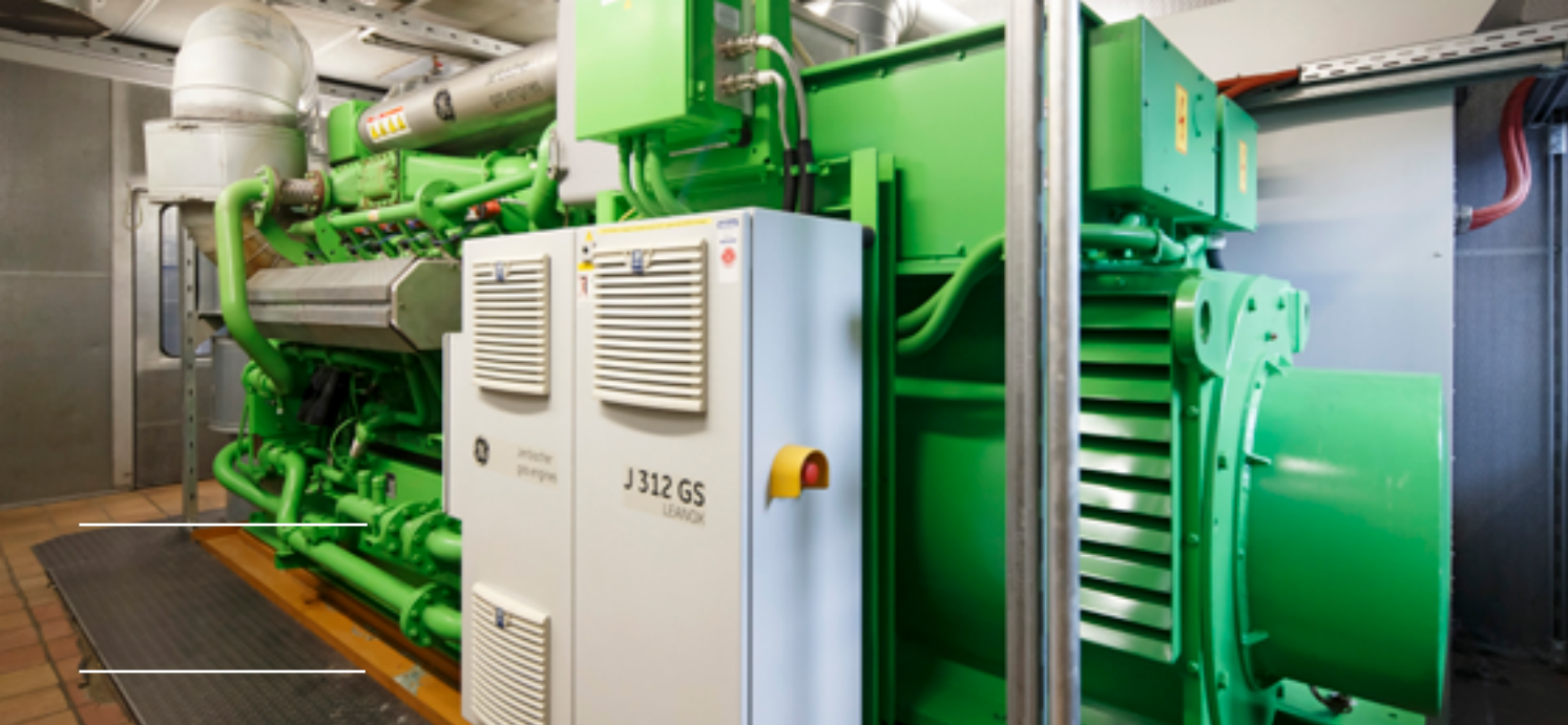
BHKW-Modul im Klärwerk mit einer elektrischen Leistung von 635 Kilowatt
