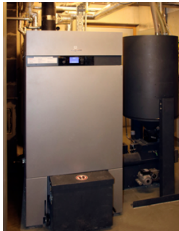
Abb. 14: Pelletkessel mit Vorratsbehälter
